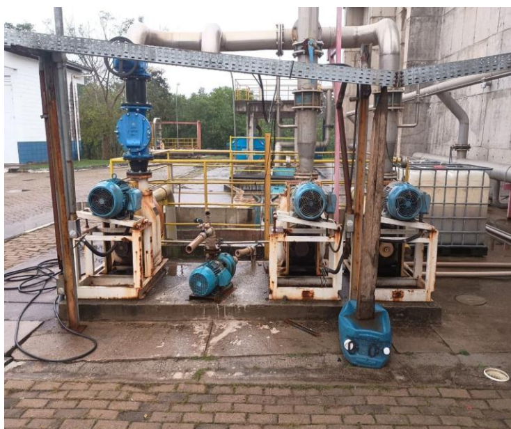
Foto 1 – Bomba centrífuga Equipe modelo ESL-6 instalada no sistema de recalque de efluente da ETE Samambaia – SAAESP (São Pedro/SP).
