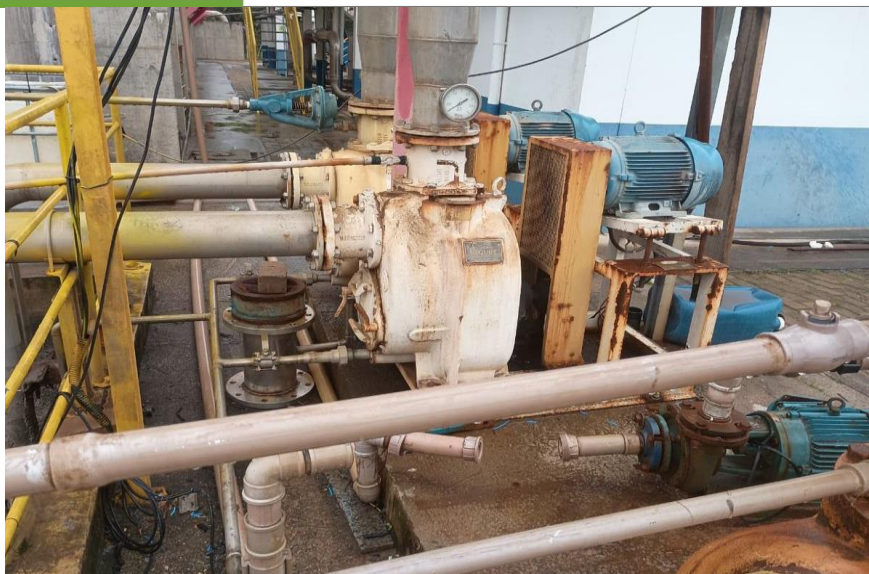
Foto 2 – Vista geral do conjunto de quatro bombas Equipe ESL-6 do sistema de recalque de efluente da ETE Samambaia – SAAESP (São Pedro/SP).
