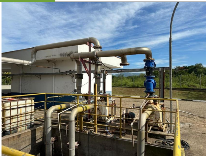
Foto 3 – Vista geral da casa de bombas e das linhas de recalque. Conjunto de bombas Equipe ESL-6 com alimentação DN 150 mm e tubulação de aço inoxidável.
