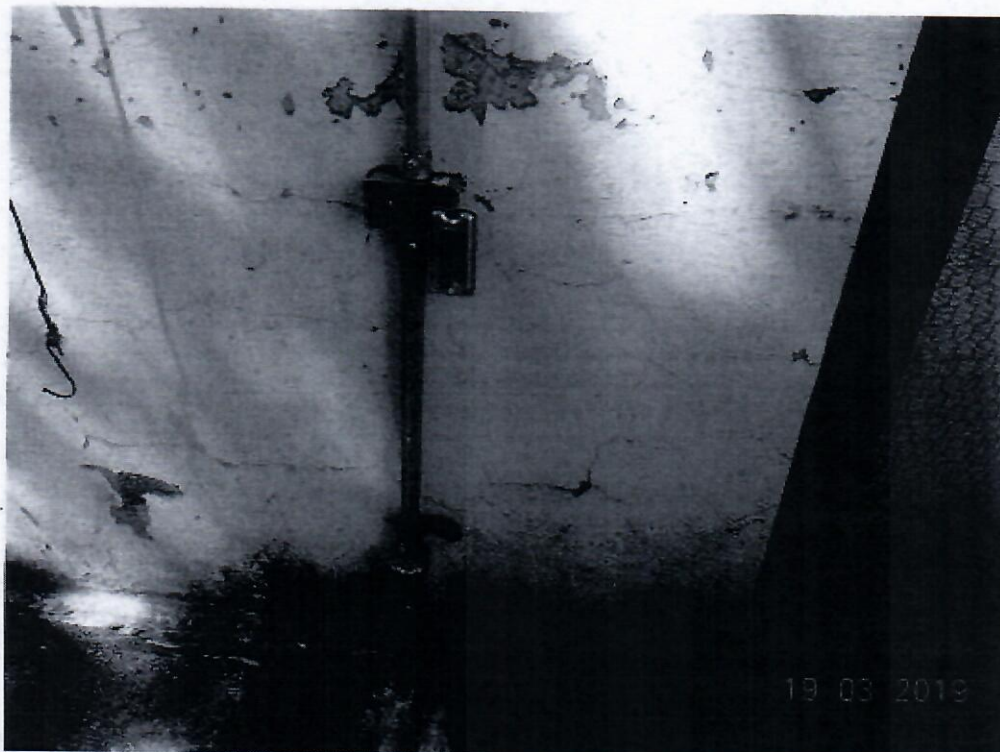
Foto 17 – Caixa e conduites do sensor de nível instalado no Reservatório Cx. Mãe
