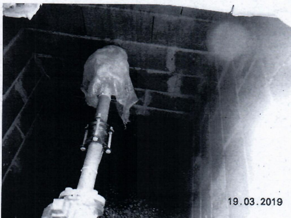
Foto 20 – Macromedidor de vazão instalado em tubulação do recalque do Reservatório do D. Industrial
