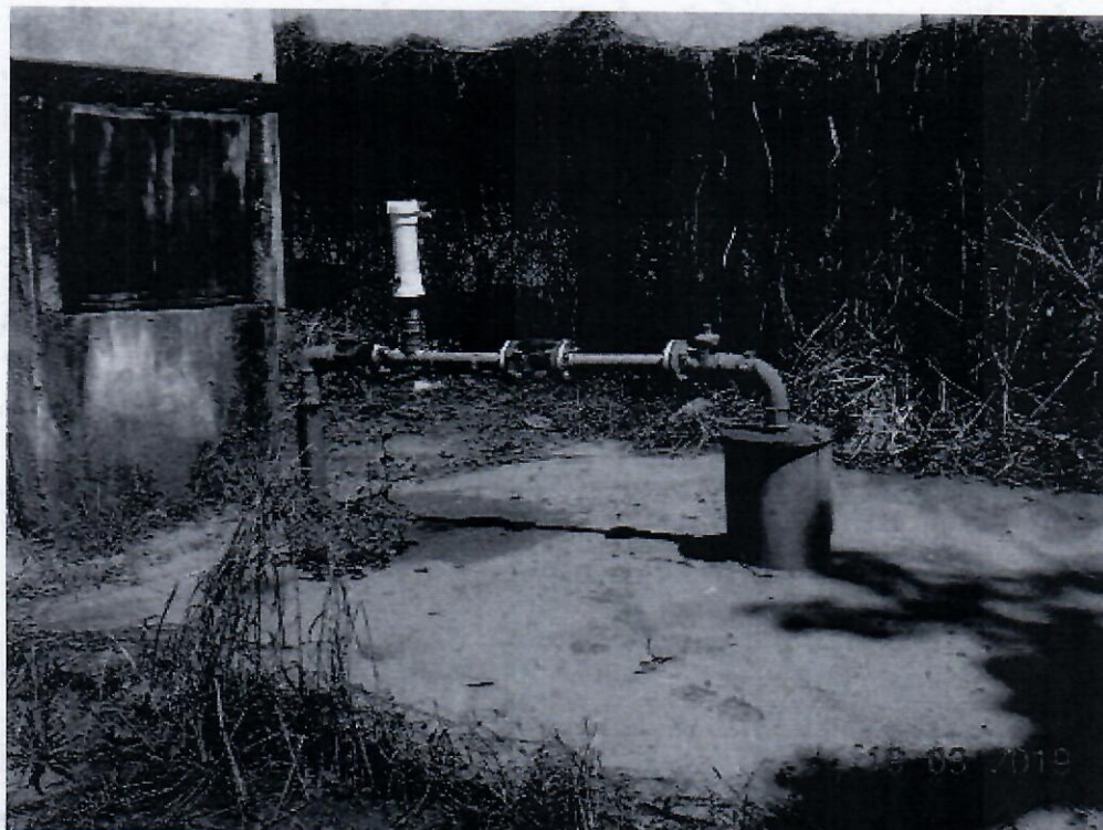
Foto 19 – Macromedidor de vazão instalado em tubulação do Poço Leopoldina
