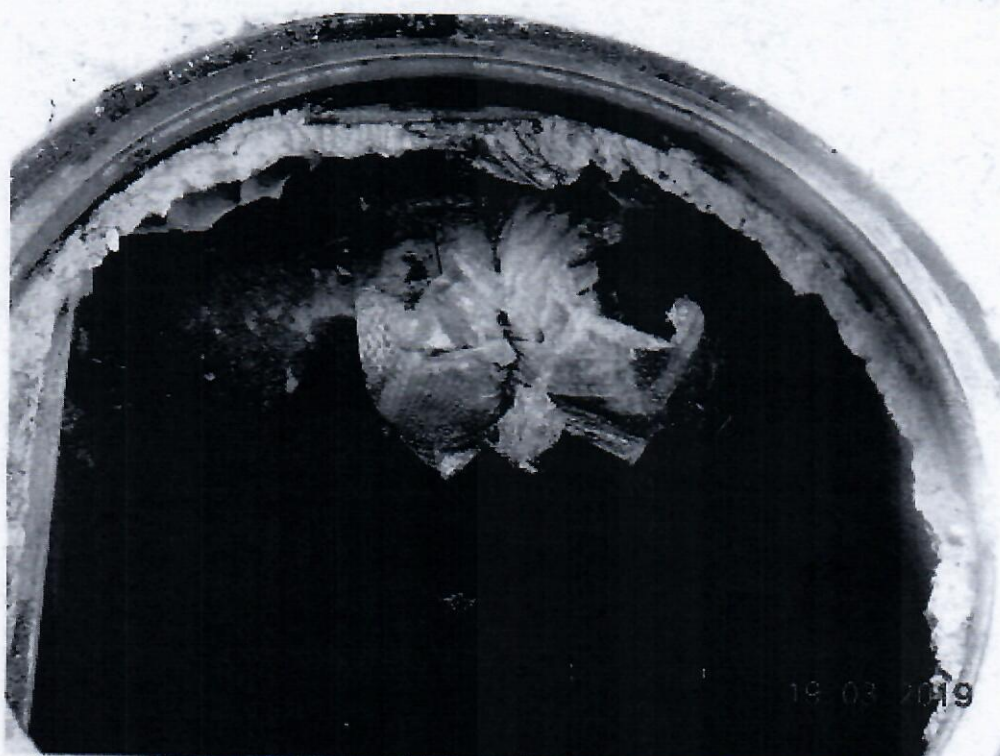
Foto 12 – Macromedidor de vazão instalado em tubulação do Reservatório Apoiado Central
