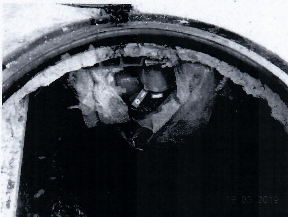
Foto 10 – Macromedidor de vazão instalado em tubulação do Reservatório Elevado Central
