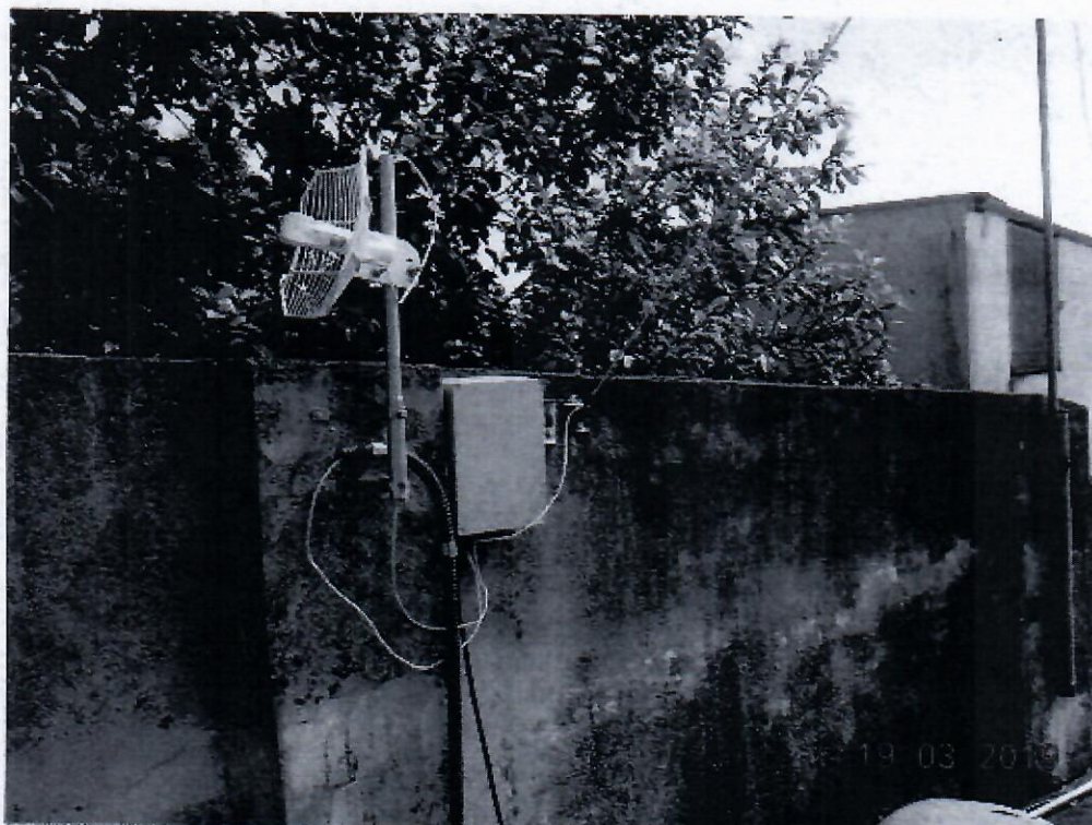
Foto 9 – Antena do sistema de telemetria do Reservatório Caixa do Meio
