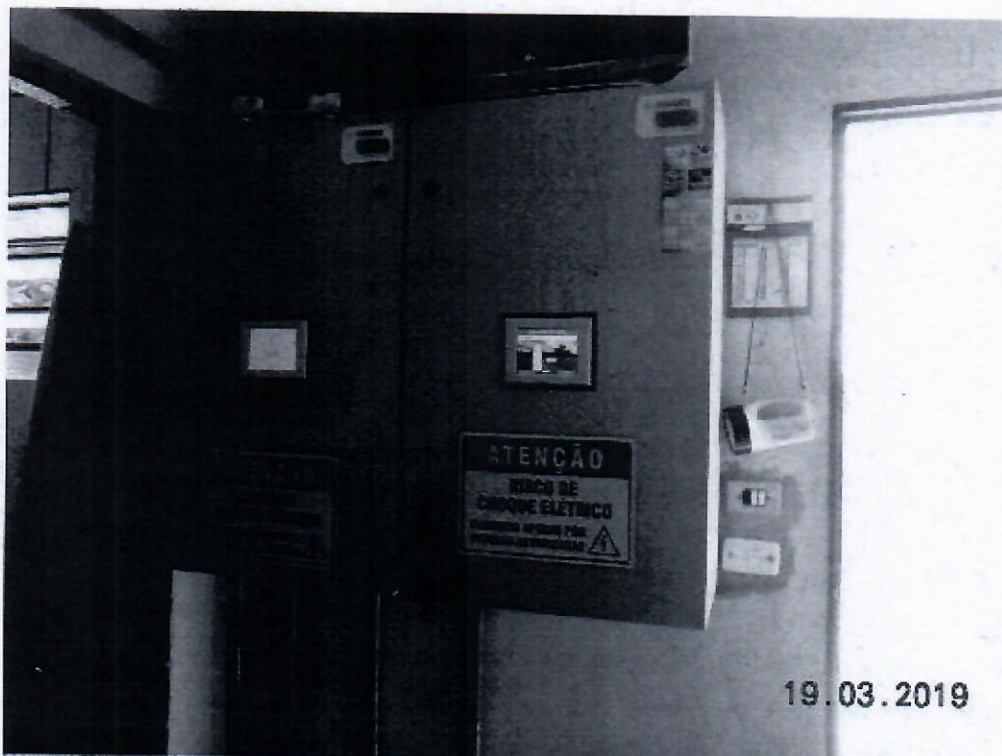
Foto 5 – Painel de Comando / telemetria instalado no Reservatório São Carlos
